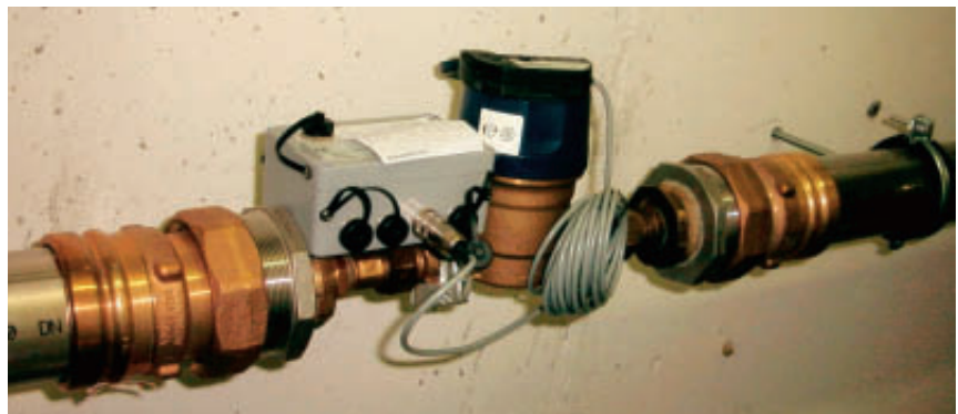
Abb. 1: Messanordnung mit Ringkolbenzähler und Datenlogger
